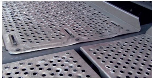
Laufsteg geringfügige Verformung
