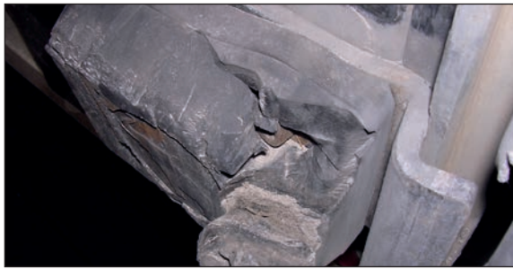
Anfahrsschaden Anbauteile Ramppuffer
