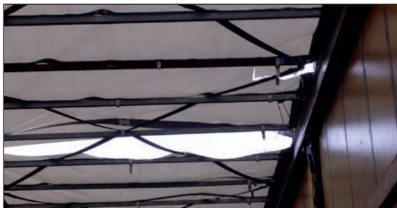
Bruch Dachholme/Riss Dachplane
